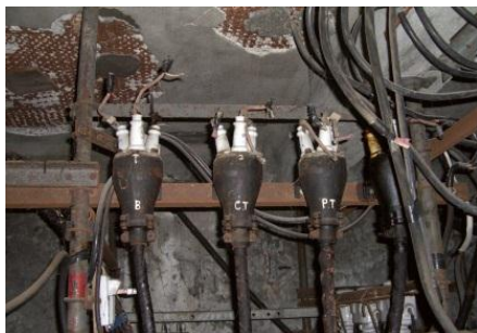
老朽化した変電設備 (停電・火災の危険性あり)
