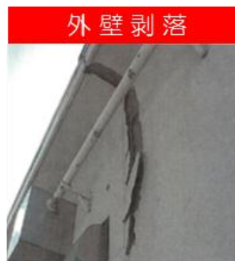
外壁剥落 ■ 外壁 経年46年 外壁が経年劣化により亀裂を生じ剥落。
