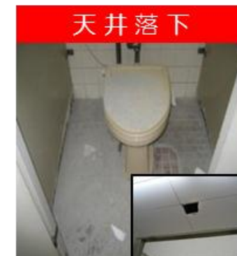
天井落下 ■ 床スラブ 経年31年 上階の便器固定用モルタルの落下により、天井を突き破り床まで落下。
