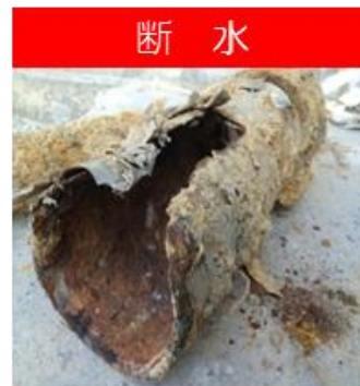
断水 ■ 排水管 経年36年 劣化により腐食、破損し、排水が漏洩。
