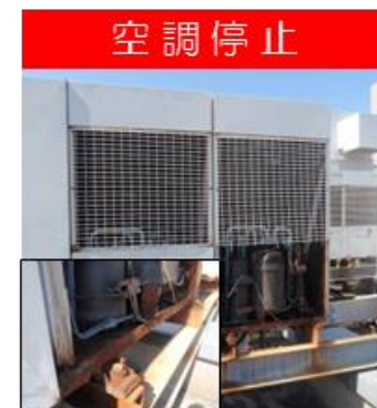
空調停止 ■ 空調機 経年23年 内部部品が腐食したため、温度調節ができない状態。
