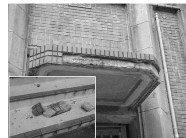
▲外壁タイルの剥落
