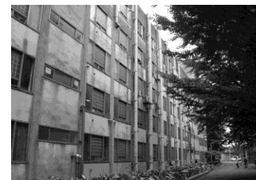
▲老朽施設の外観(経年48年)
