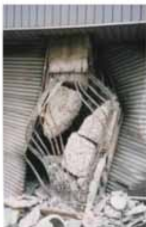
柱のせん断破壊
