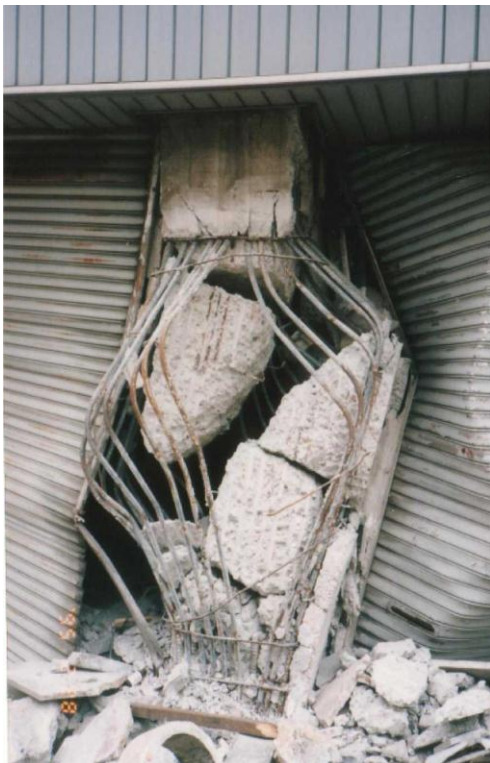
柱のせん断破壊
