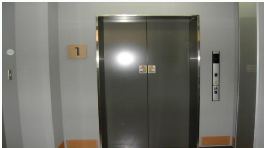
バリアフリーの観点からエレベーターを設置しました。
