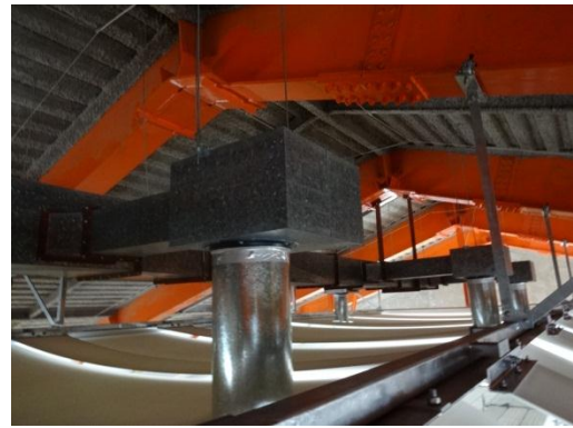
天井裏の空調設備の例
