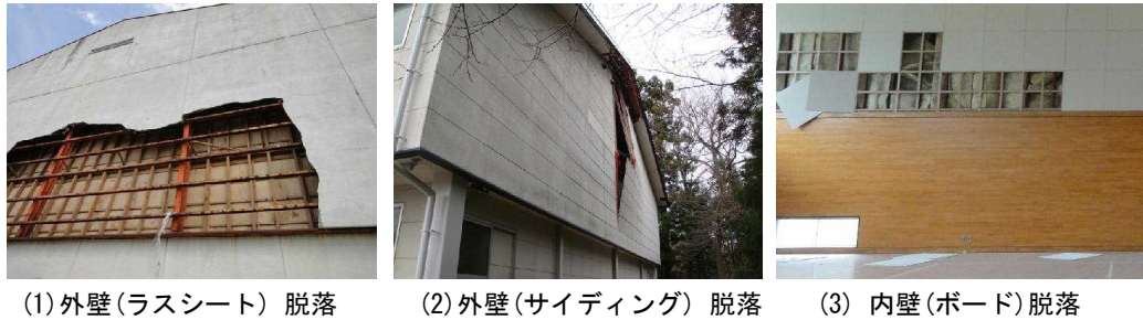
写真4 外壁・内壁の脱落
