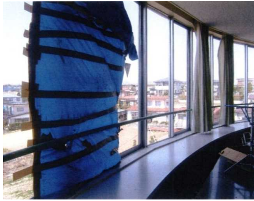
写真15 横連窓の障子ごとの脱落 (4階音楽室)
