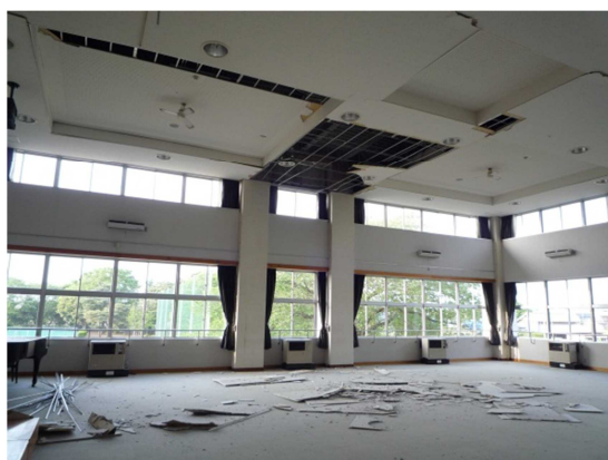
写真10 階高の高い大空間の天井の脱落
