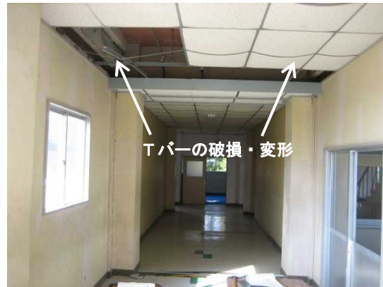
写真 13 Tバーの破損・変形（廊下）
