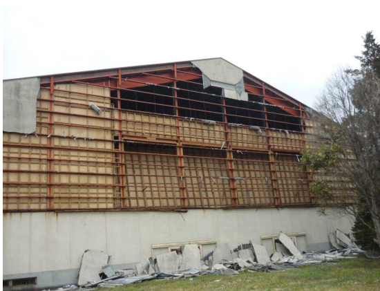
写真 7 外壁妻壁のラスシートの全面脱落
