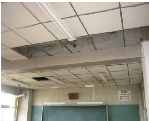
写真 12 システム天井の脱落（普通教室）
