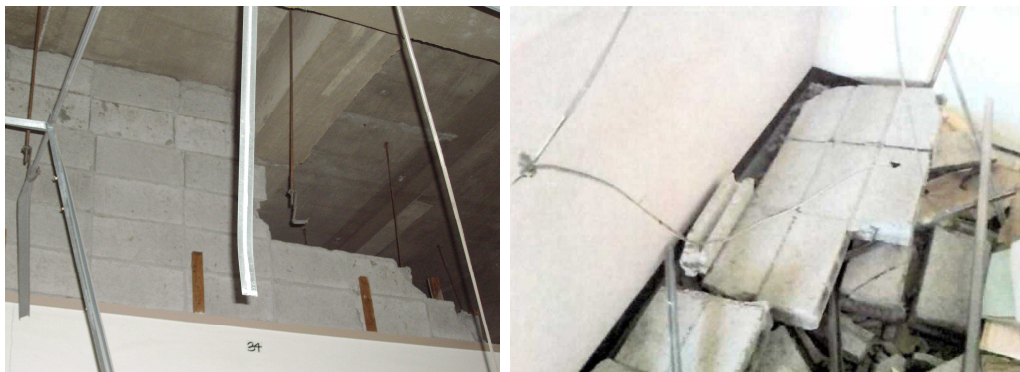
写真 5 コンクリートブロック壁の一部脱落
