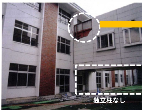
写真17 外装材 (押出成形セメント板) の脱落
