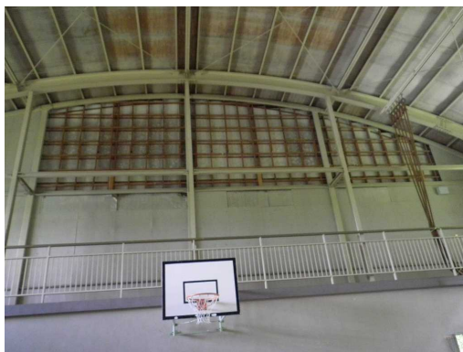
写真 8 内壁（有孔ベニヤ板）の脱落
