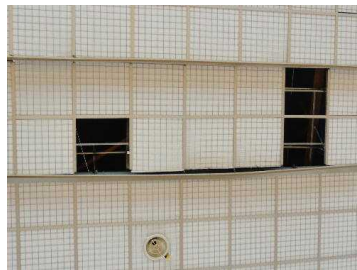
(2) 一部脱落の例 1
