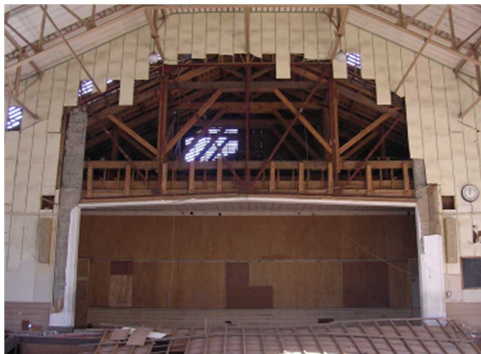
ステージ前部の壁の脱落
