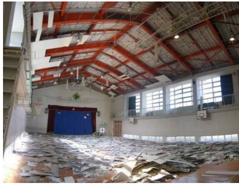
全国的な天井材の被害
