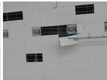
(3) 一部脱落の例 2
