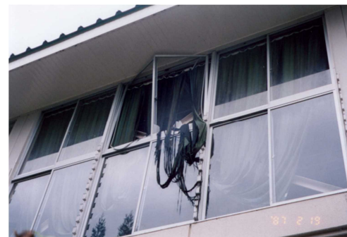
窓ガラスの破損
