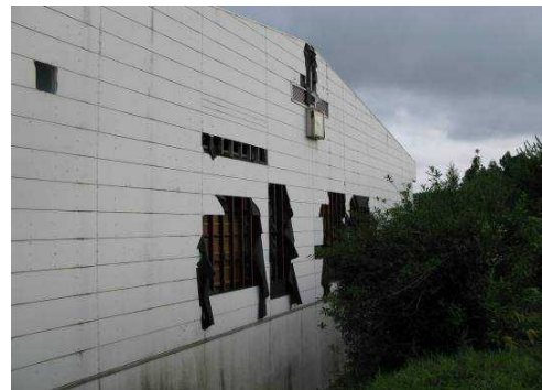
外装材の損傷
