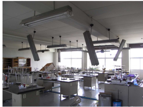
照明器具の脱落
