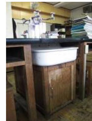
度重なる配管の破損
