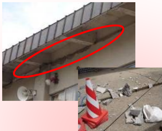
老朽化により コンクリート片が落下
