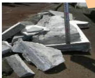
老朽化により モルタルが落下
