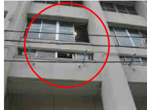
障子の落下箇所
