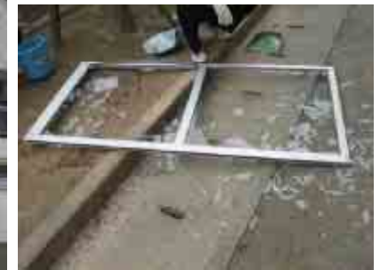
落下して破損した障子
