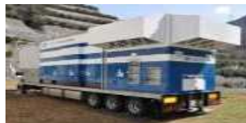
非常用ディーゼル発電機の代替空冷電源設備(4,000kVA)の設置
