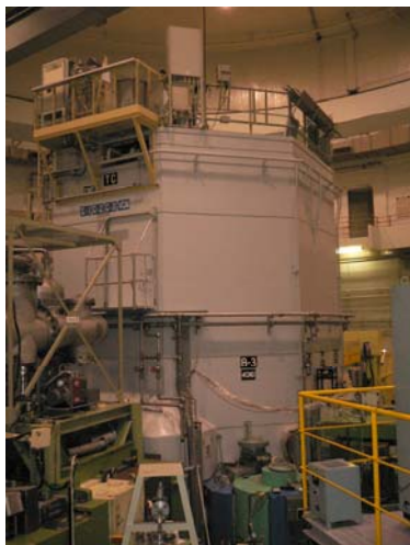
生体遮へい体(原子炉本体)の外観
