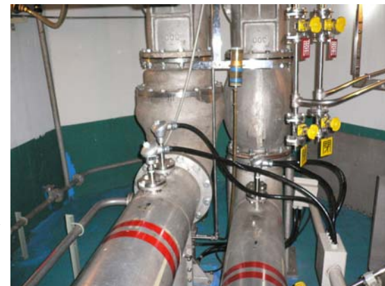
1次冷却系配管(炉心直下部)
