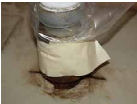
塩化ビニルシートの剥がれによる排水配管との隙間
