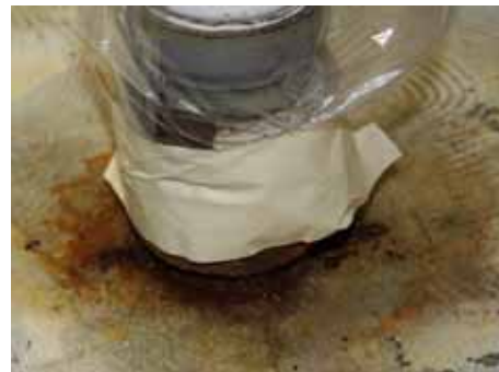
排水配管周囲のしみ (塩化ビニルシートを剥がした後)
