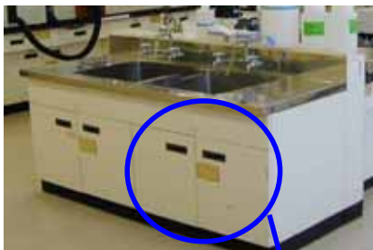
漏水した当該流し
