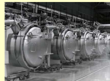
プラント設備(槽・配管等)
