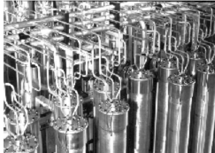
パイロットプラント遠心機
