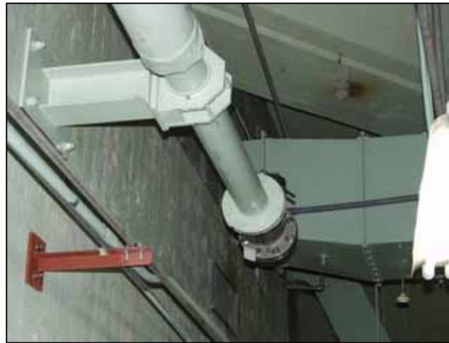
軽水注入系設備
