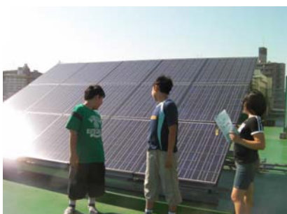
校舎屋上に設置
