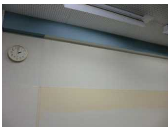
（黒板が設置されていた壁の状況）
