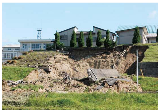
平成20年岩手・宮城内陸地震で被災した学校被害(学校敷地のり面の崩落)
