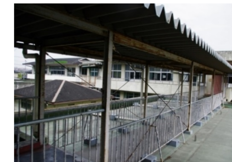
昇降口屋根に設置された渡り廊下構造上バリアフリー化が困難。
