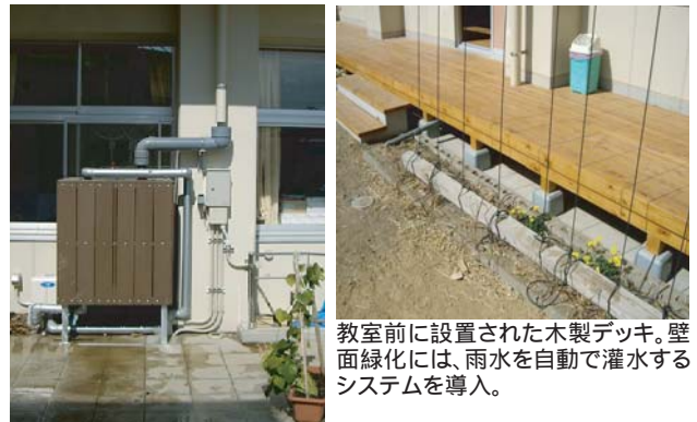
新しく設置された雨水タンク。
