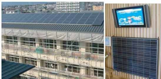
教室棟屋根に設置された太陽光発電パネル。廊下には実物大のパネルと表示パネルを設置。
