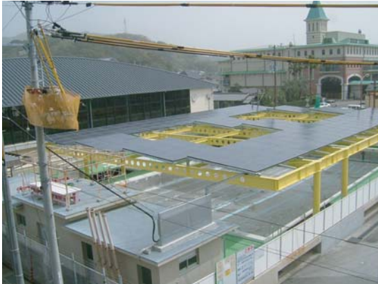
紫外線対策を兼ねてプールの屋上に設置された太陽光発電パネル。
