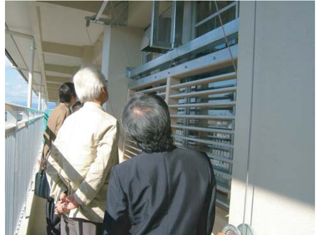
教室も南側開口部には、木製のルーバーを設置。実物サンプルを作り、現場で確認。
