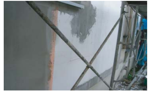
断熱材貼付け(白色)後、メッシュ(オレンジ)を貼り、ベースコートを塗装中。
