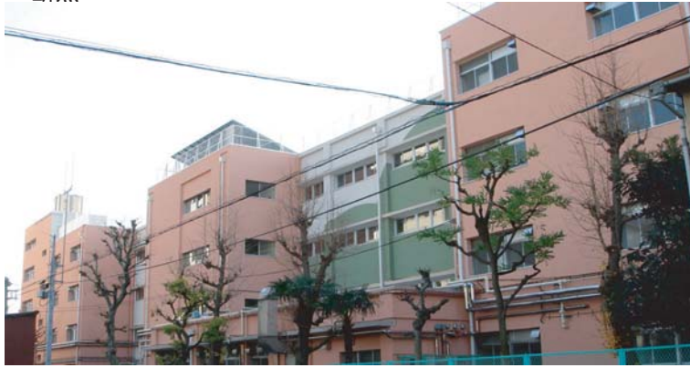
外壁を補修し、ペアガラスサッシ、外断熱にした校舎棟。北側からの外観。
