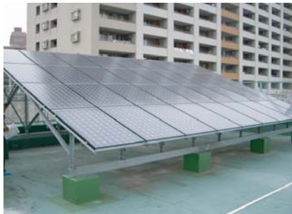
校舎棟屋上に設置された太陽光発電パネル。容量 7.2kW、モジュール36枚。
