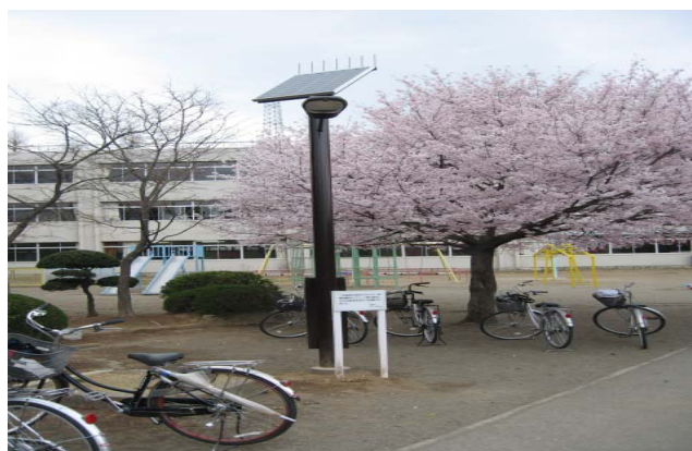
〔太陽光発電照明灯〕
