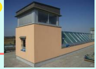
換気塔を設置し、冬期はファンを回して暖気を対流させる。
