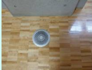
地中熱利用(地中熱吹き出し口)
