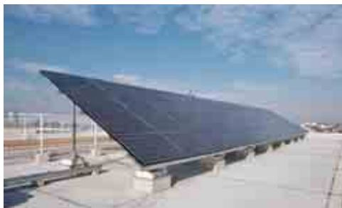
屋上に10kWの太陽光発電パネルを設置。 (埼玉県富士見市立つるせ台小学校)
