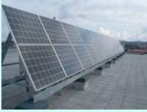
太陽光パネル
