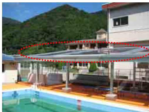
プールサイドに5kWの 庇兼用太陽電池パネル を設置。 (長崎県大村市立黒木小学校)
