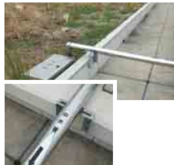
雨水の貯蔵を行い、グラウンド・屋上緑化の散水に利用。 (大分県大分市立上野ヶ丘中学校)
